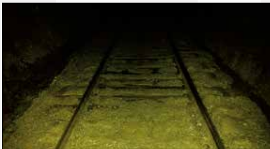
Slika 3. Dio tunela prekriven vodom i blatom
